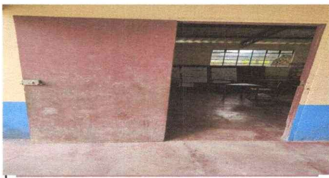
Foto 6: Las puertas de los establecimientos se encuentran en mal estado.
