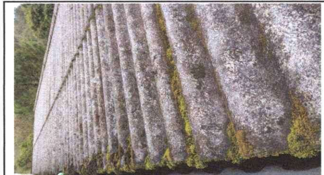
Foto 3: Se observa el deterioro del techo, módulo I
