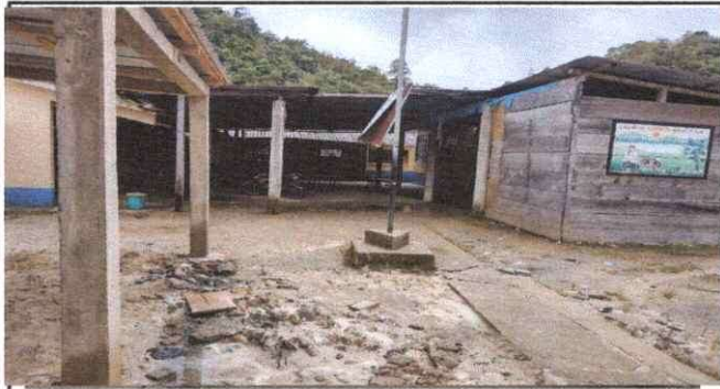
Foto 1: Vista frontal de los módulos que se encuentra en mal estado, las láminas
